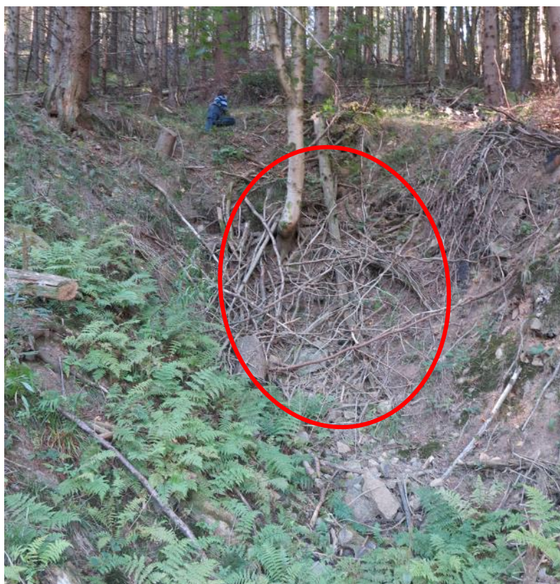
Photo 29 : Galerie G17 éboulée en tête
