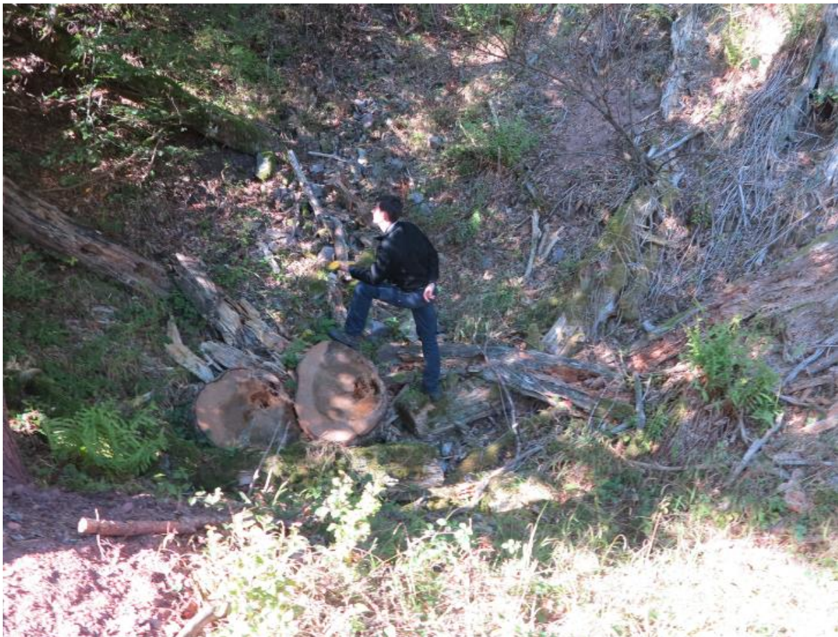
Photo 72 : Désordre D10 de type fontis à l'aplomb de travaux souterrains
