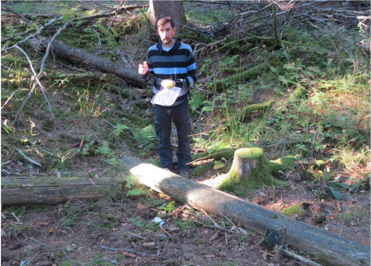
Photo 43 : Désordre D8 à l'aplomb de la galerie G22
