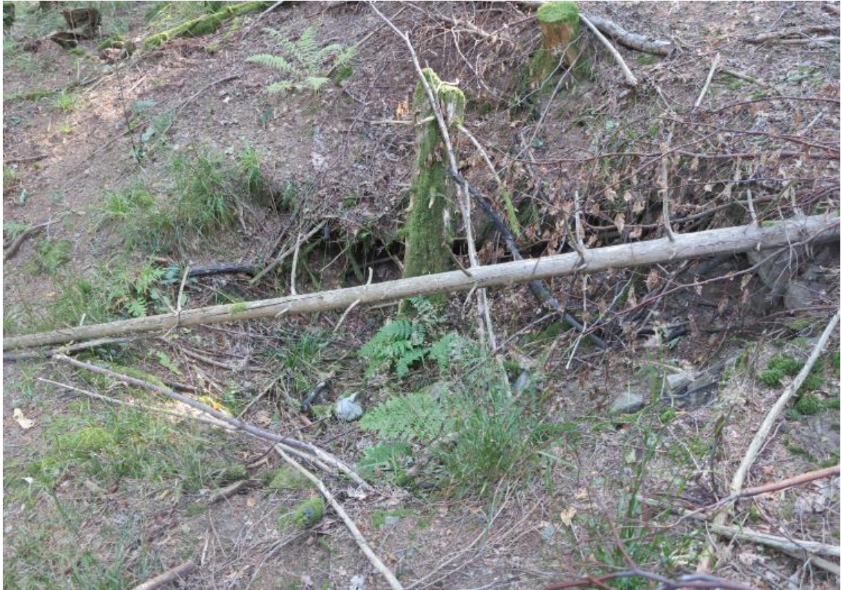
Photo 41 : Désordre D6 à l'aplomb de la galerie G22
