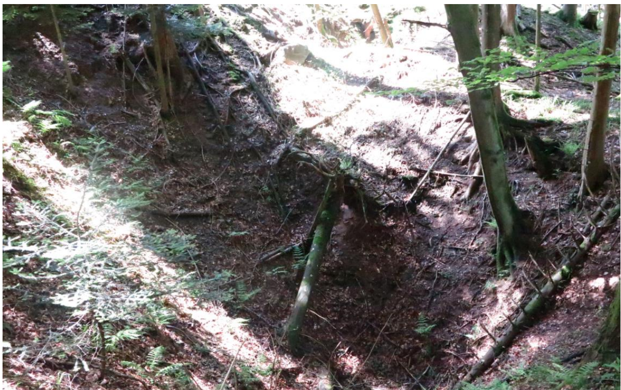
Photo 11 : Désordre D5 au niveau de la mine à ciel ouvert de la Mine Grise MCO1
