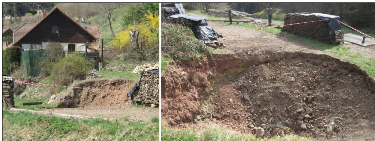
Figure 43 : Désordre D1 de type fontis dans le secteur des Minières (clichés GEODERIS, mars 2014)
