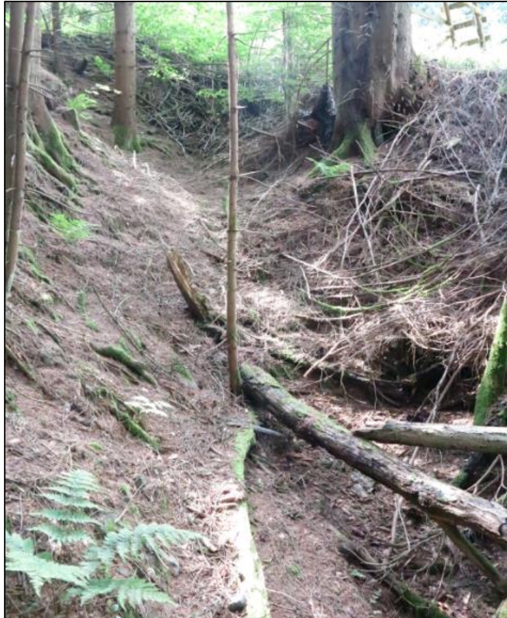
Figure 20 : Photographie de la galerie éboulée en tête de la « Recherche du Curé » G15 (cliché GEODERIS, 29/09/2015)
