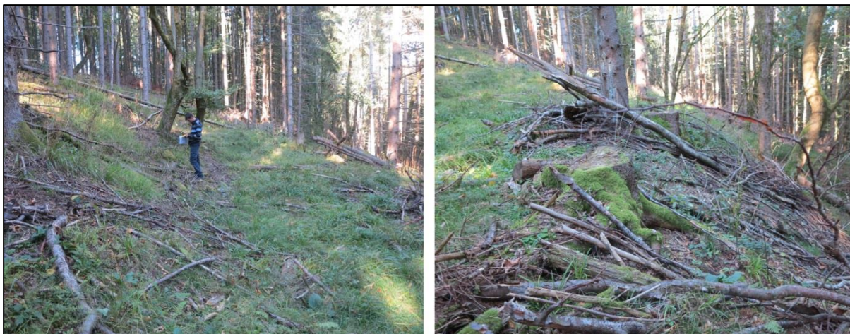
Figure 25 : Galerie de recherche G21 éboulée en tête et son ouvrage de dépôt T22 (clichés GEODERIS, 30/09/2015)
