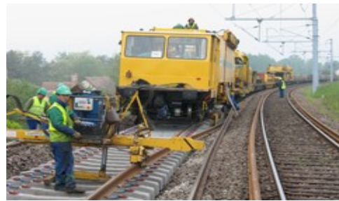
Longs Rails soudés sur traverses béton
