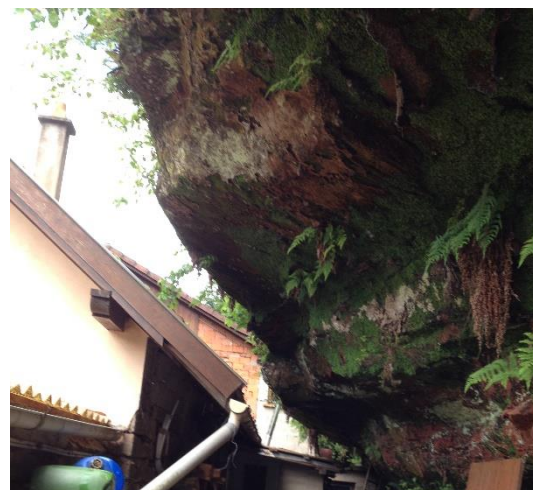
Surplomb situé en arrière d'une habitation
