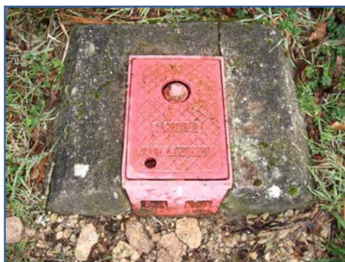
Bouche de lavage fermée
