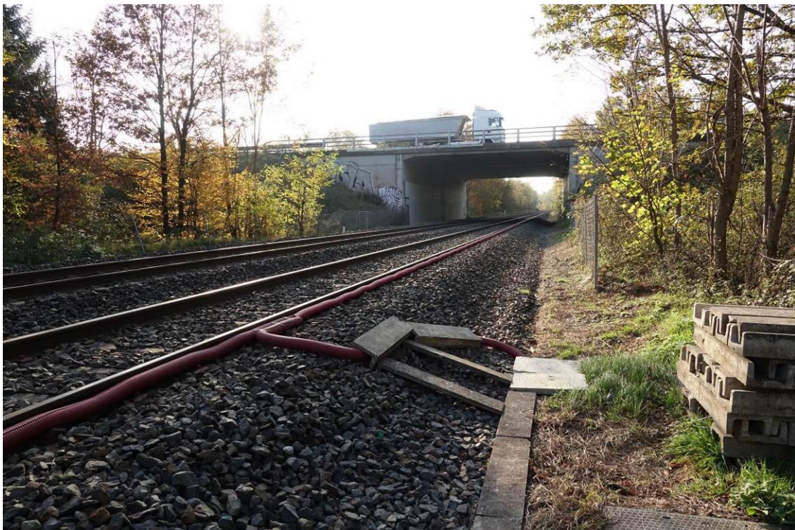
Franchissement de l'A4 par la voie ferrée utilisé par la faune dont les chiroptères (Grand Murin et Sérotine commune) pour franchir l'autoroute
