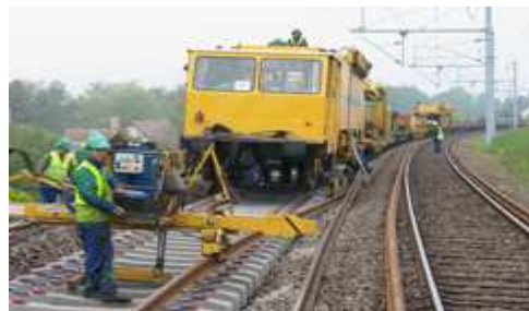
Longs Rails soudés sur traverses béton
